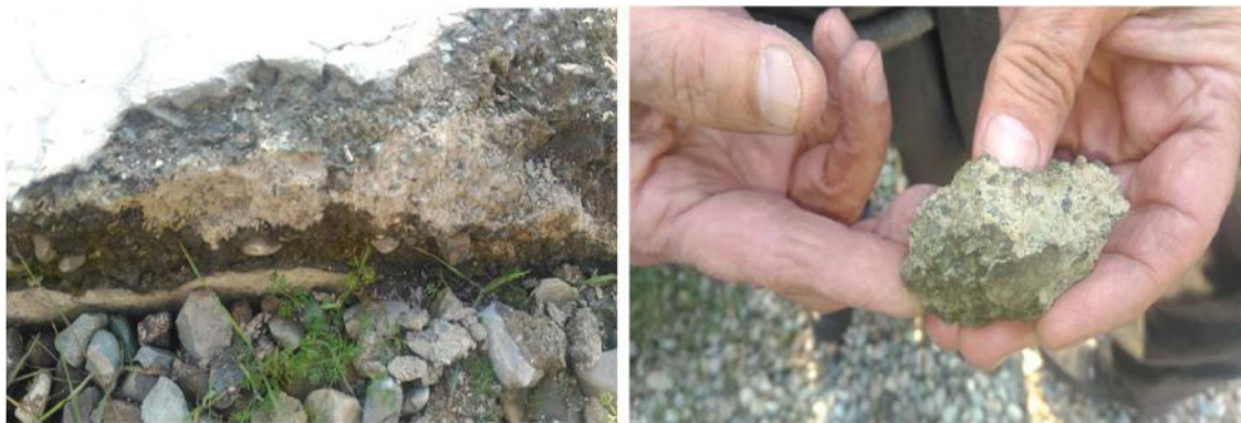
فساد بتن در لایه های زیرین برخی پایه های پست ازگل
